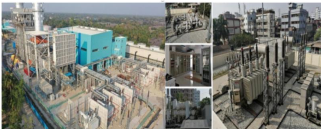
图 9：孟加拉 300MW 联合循环电站
