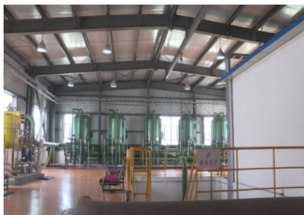
矿井水处理站
