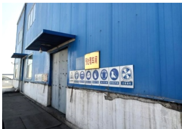
矿井水处理站预处理车间1
