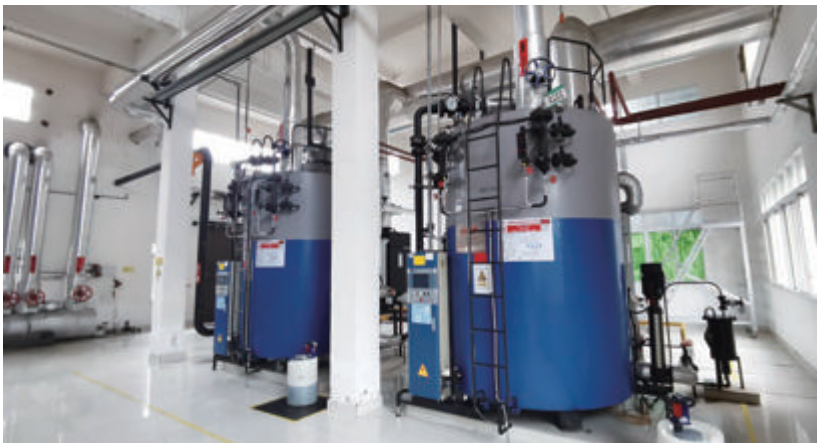
► 泸州公司 4 台燃气锅炉全部完成低氮改造
