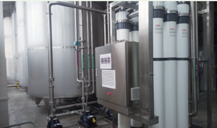
▶ 随州公司超滤水处理设备
