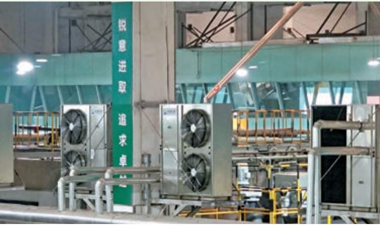
空气源热泵机组
