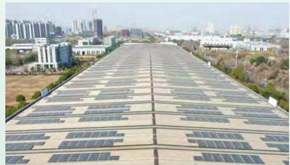
道岔联合厂房屋面光伏
